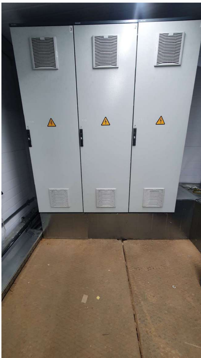
Электросиловые шкафы, в помещении
