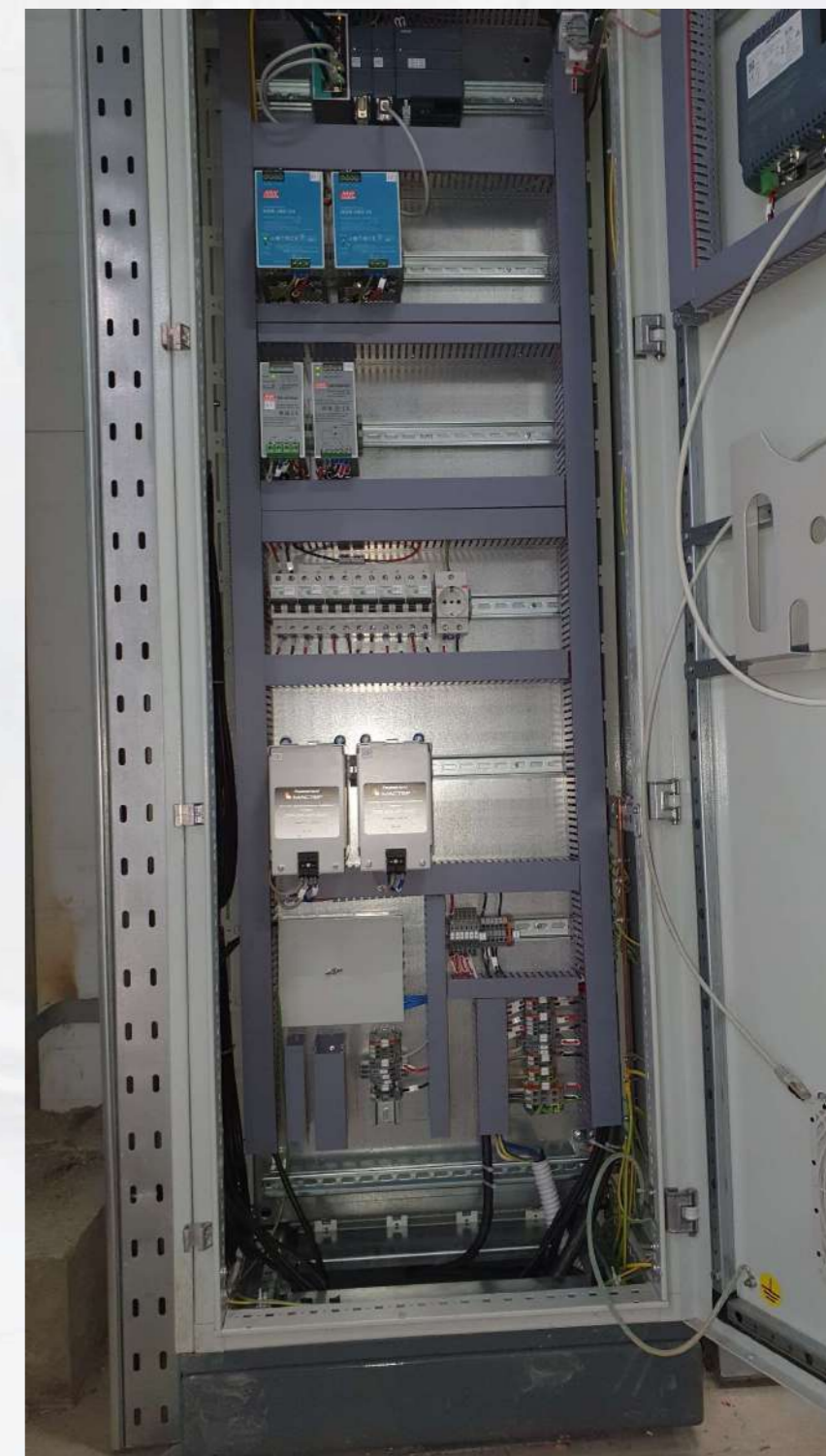
Шкаф автоматики, в помещении
