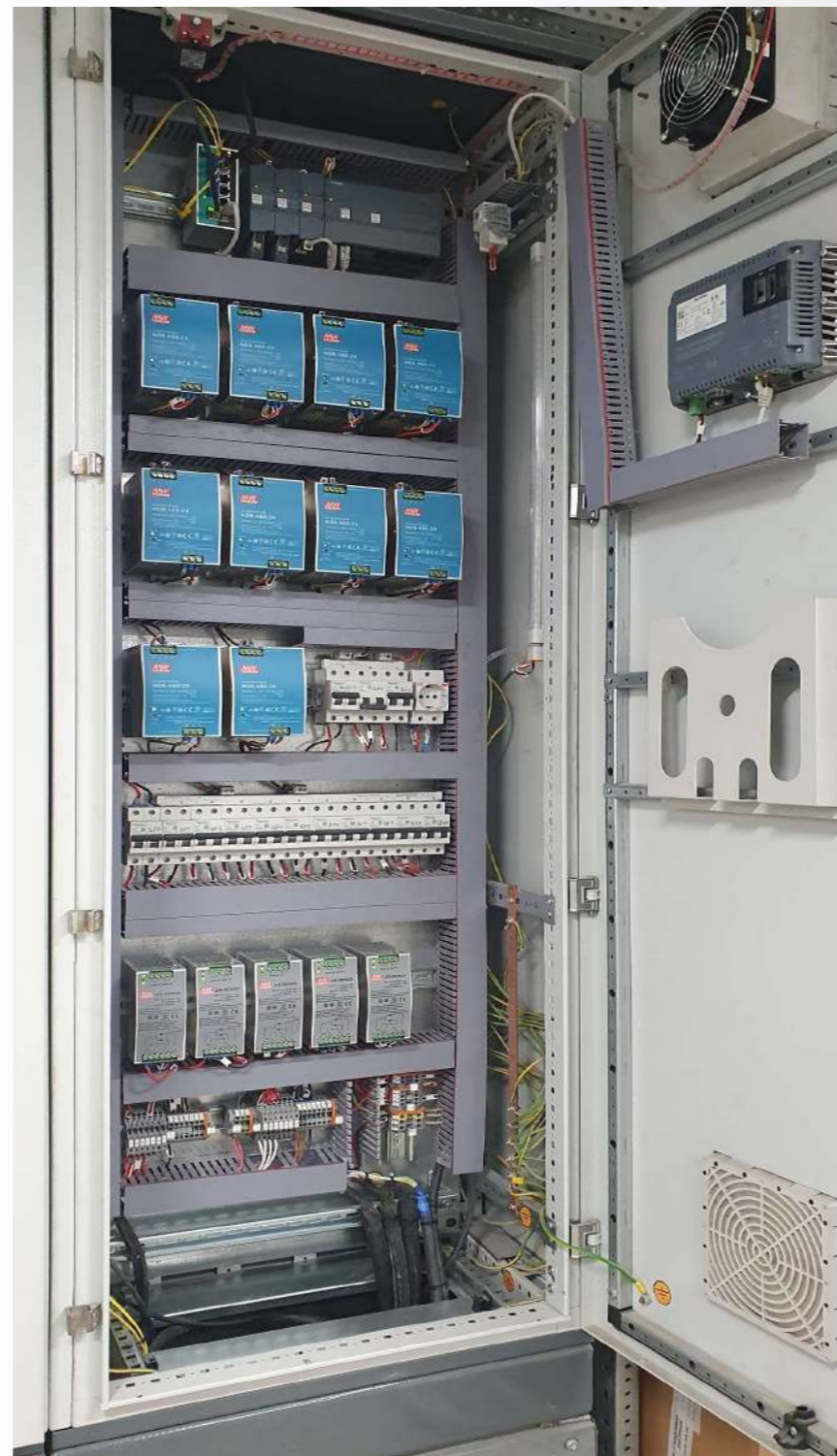
Шкаф питания ПЛК
