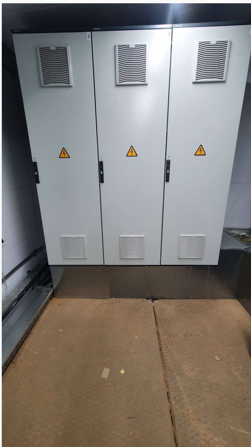
Электросиловые шкафы, в помещении
