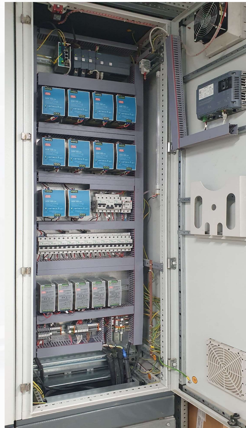
Шкаф питания ПЛК
