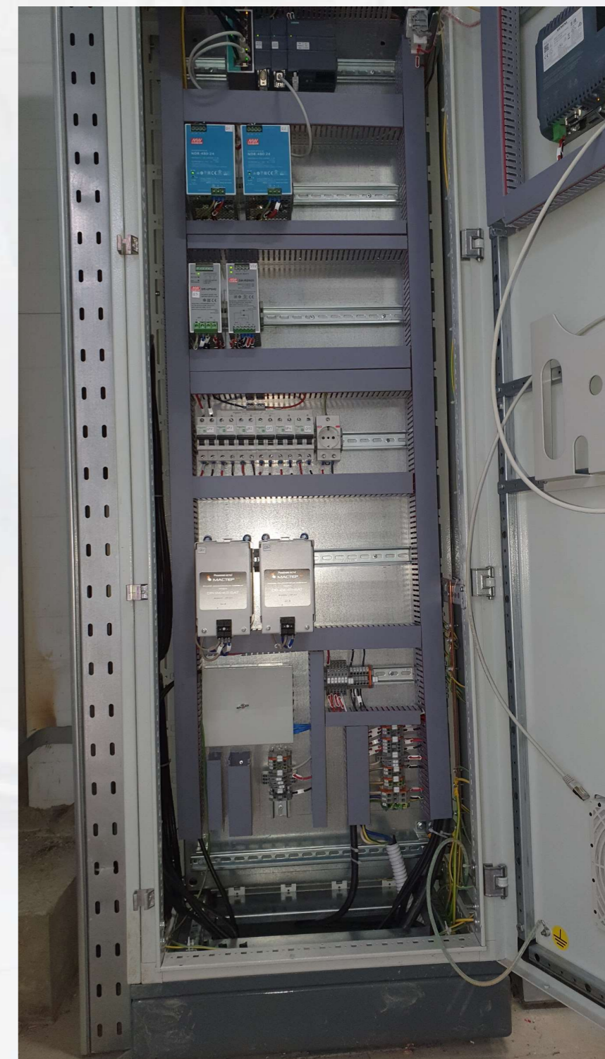
Шкаф автоматике, в помещении
