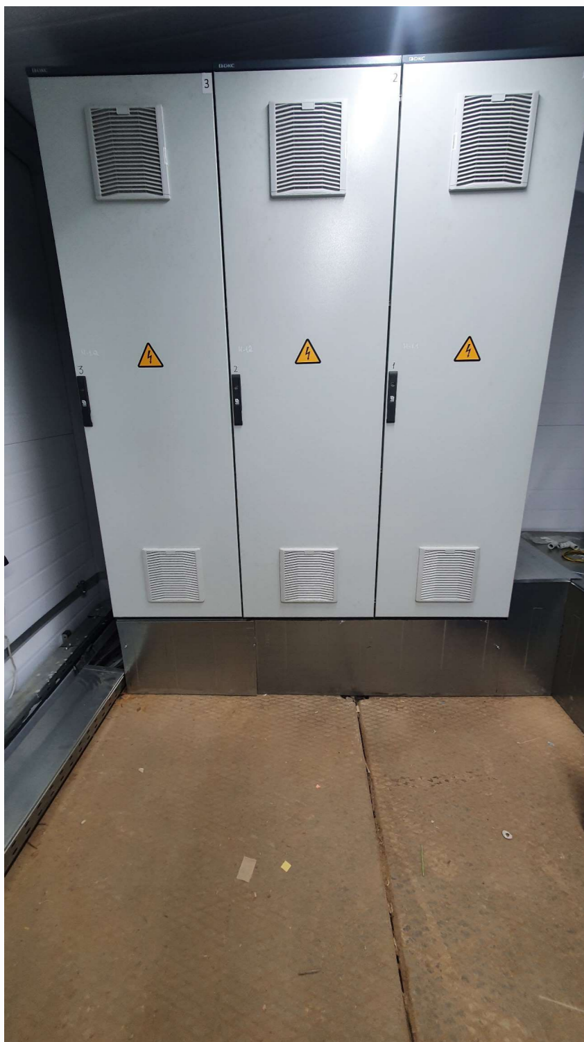
Электросиловые шкафы, в помещении
