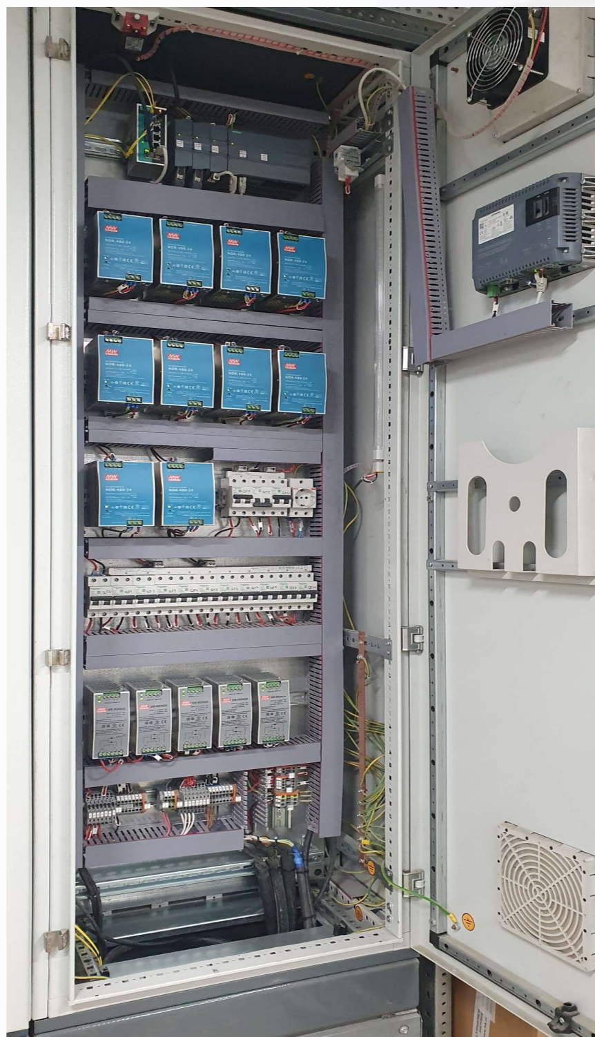
Шкаф питания ПЛК
