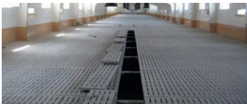
Рисунок 4.4.1.2 – Бетонные ванны сбора отходов, накрытые щелевыми полами
