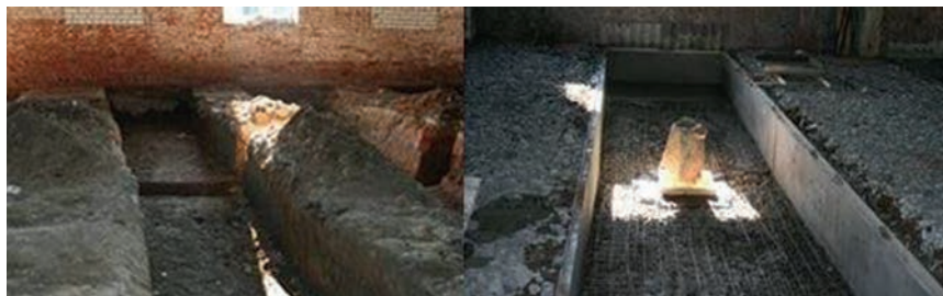
Рисунок 4.4.1.3 – Бетонные ванны свинарника со значительным разрушением
