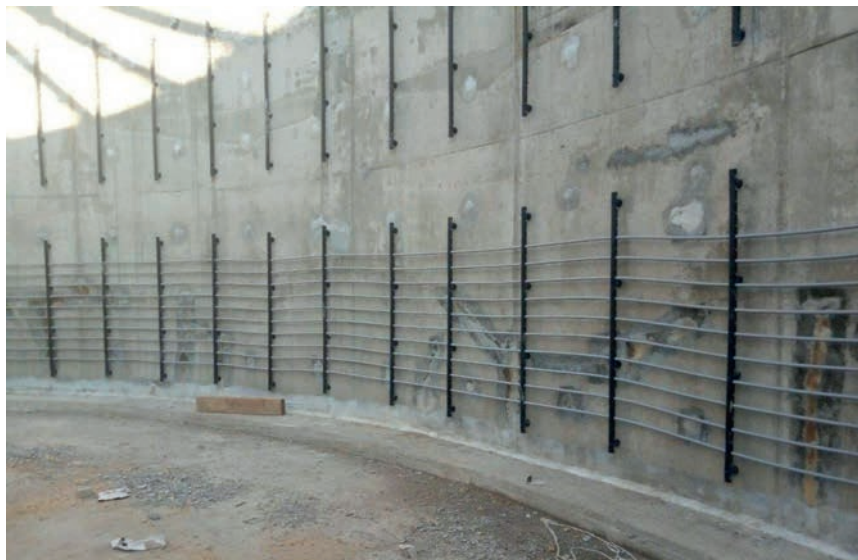
Рисунок 4.5.6 – Трубы подогрева биомассы внутри биореактора
