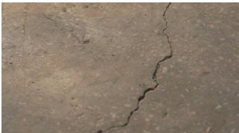
Рисунок 6.6.1 – Подвижная трещина в полу
