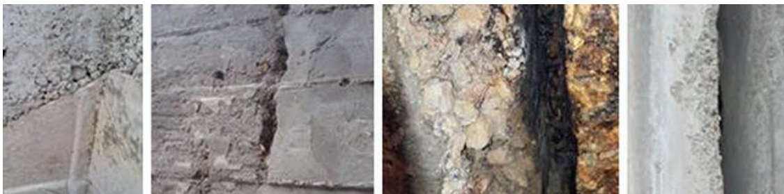
Рисунок 6.3.1.1 – Поверхностные дефекты бетона
