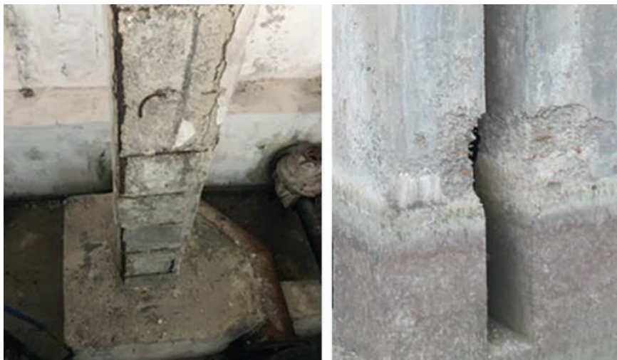
Рисунок 6.3.2.2 – Несущие железобетонные колонны с поврежденным защитным слоем бетона и участками оголенной арматуры
