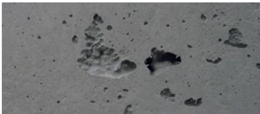
Рисунок 6.3.6.1 – Дефекты бетонной поверхности
