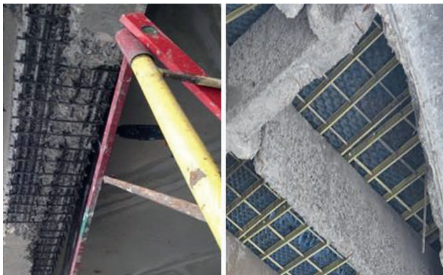
Рисунок 6.3.3.1 – Монолитные участки железобетонных балок с участками оголенной арматуры
