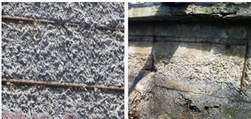
Рисунок 6.3.2.1 – Разрушенные участки бетона с оголенной арматурой
