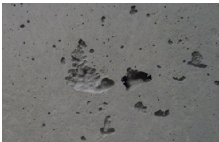
Рисунок 8.3.6.1 — Дефекты бетонной поверхности
