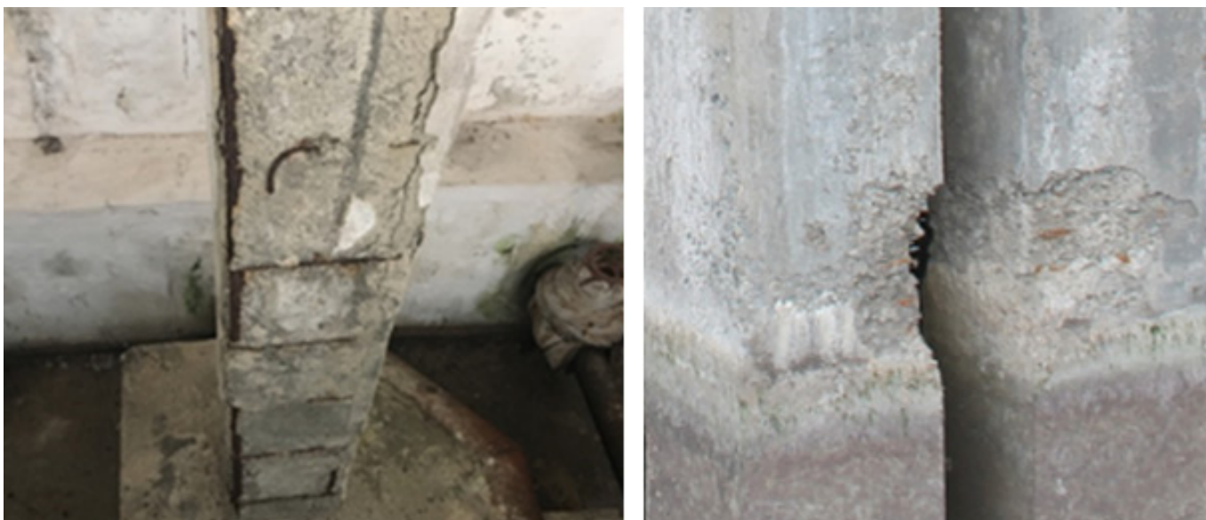
Рисунок 8.3.2.2 — Несущие железобетонные колонны с поврежденным защитным слоем бетона и участками оголенной арматуры
