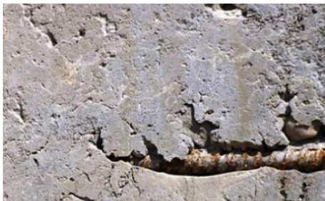
Полости от зависания бетонной смеси
