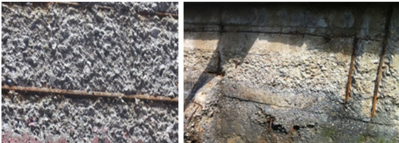
Рисунок 8.3.2.1 — Разрушенные участки бетона с оголенной арматурой
