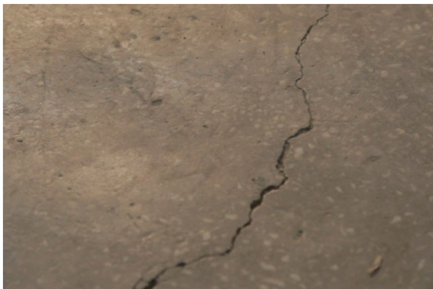
Рисунок 8.6.1 — Подвижная трещина в полу
