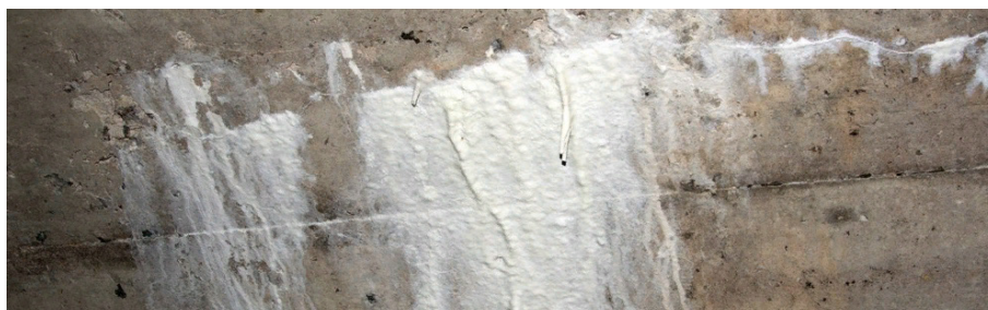
Дефекты коррозионного характера
