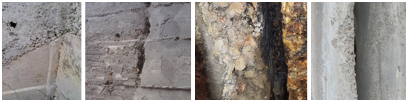
Рисунок 8.3.1.1 — Поверхностные дефекты бетона
