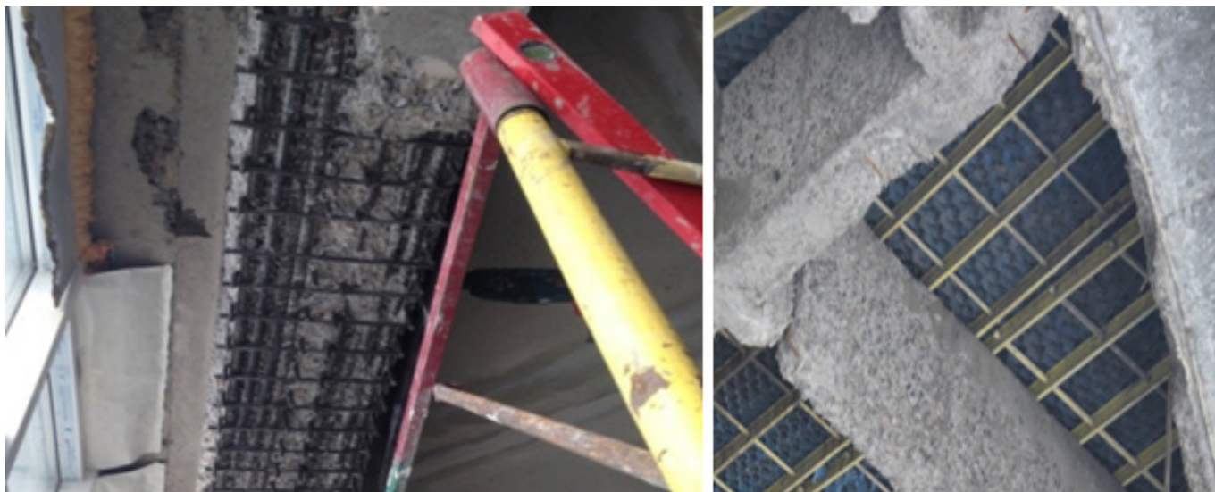
Рисунок 8.3.3.1 — Монолитные участки железобетонных балок с участками оголенной арматуры
