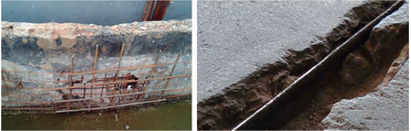
Рисунок 8.3.5.1 — Объемные разрушения бетона
