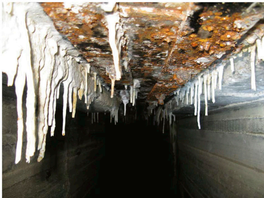
Рисунок 5.2 - Фильтрация воды через потолочное уплотнение деформационного шва с выносом гидроксида кальция и образованием «сталактитов» в соединительном коридоре между смотровыми шахтами со стороны верхнего и нижнего бьефов здания ГЭС.
