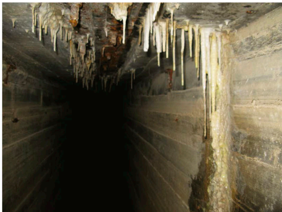
Рисунок 5.3 - Фильтрация воды с выносом гидроксида кальция через швы бетонирования и из-под потолочного уплотнения деформационного шва в соединительном коридоре между смотровыми шахтами верхнего и нижнего бьефов.
