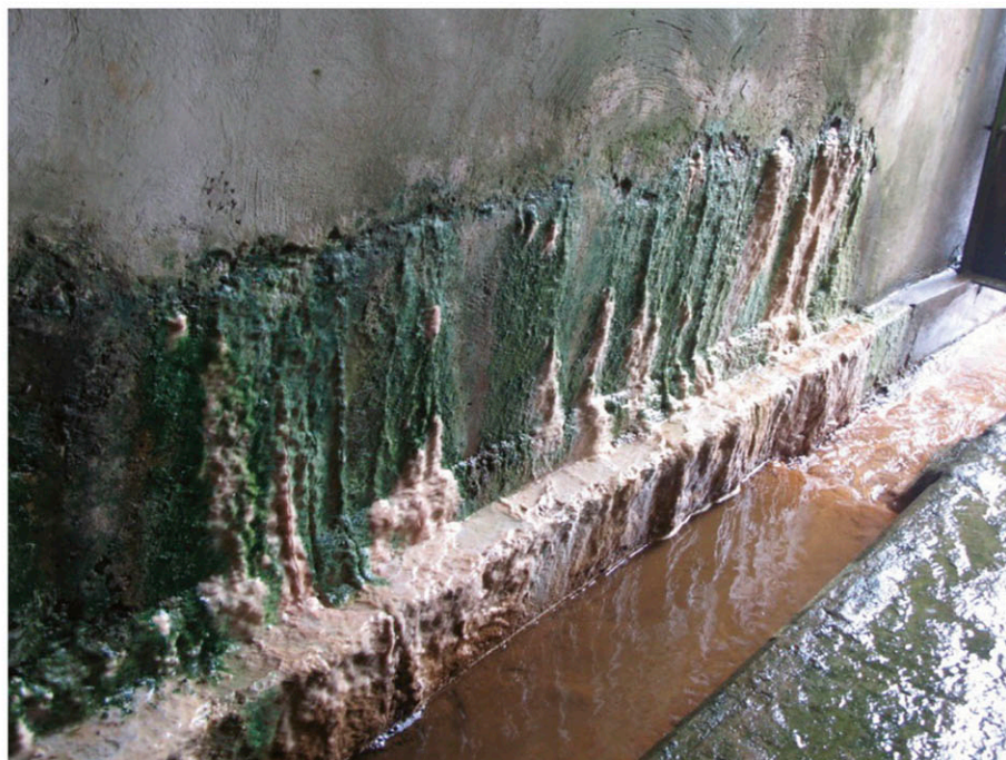
Рисунок 5.4. - Фильтрация воды через горизонтальные швы бетонирования в потерне бетонной плотины.
