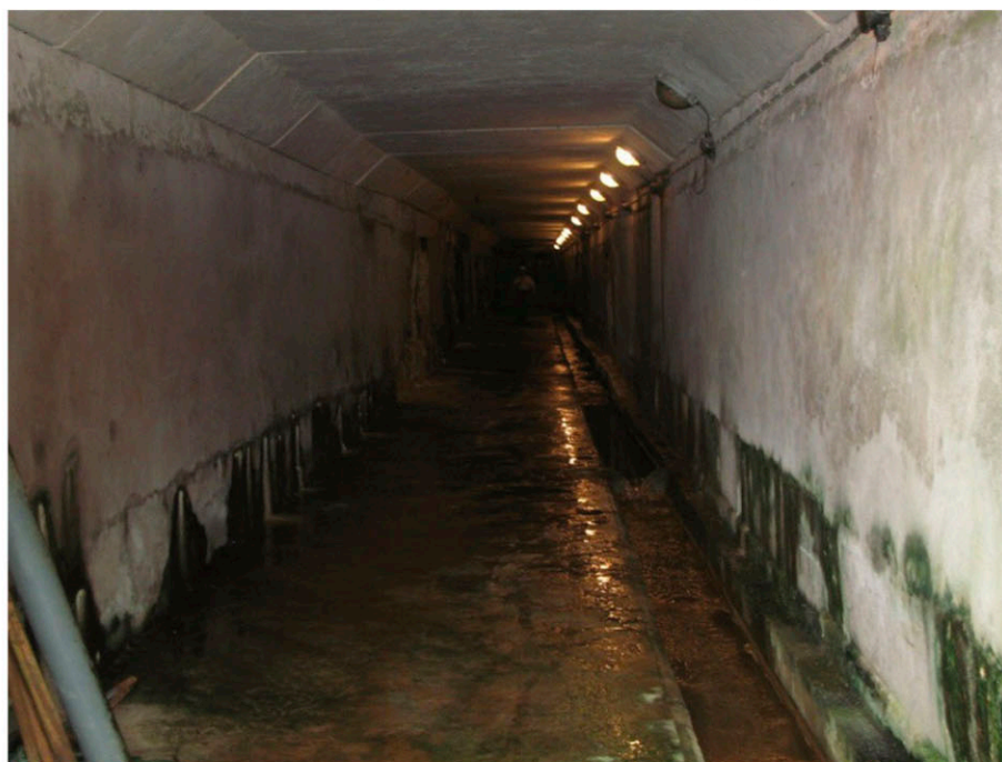
Рисунок 5.1 - Фильтрации воды в потернах бетонной плотины.
