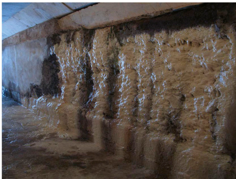
Рисунок 5.5. - Фильтрация воды через шов бетонирования между стеной и перекрытием потерны.
