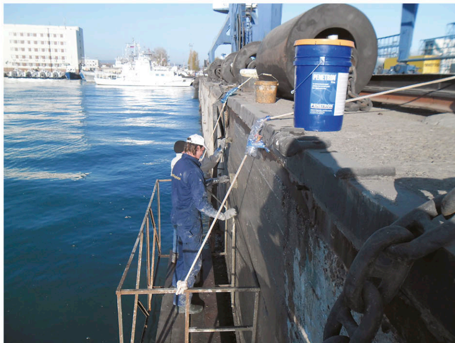
Рисунок 6.5.3 - Железобетонные причальные сооружения: а - морские причальные сооружения; б – выполнение работ по гидроизоляции причального сооружения.
