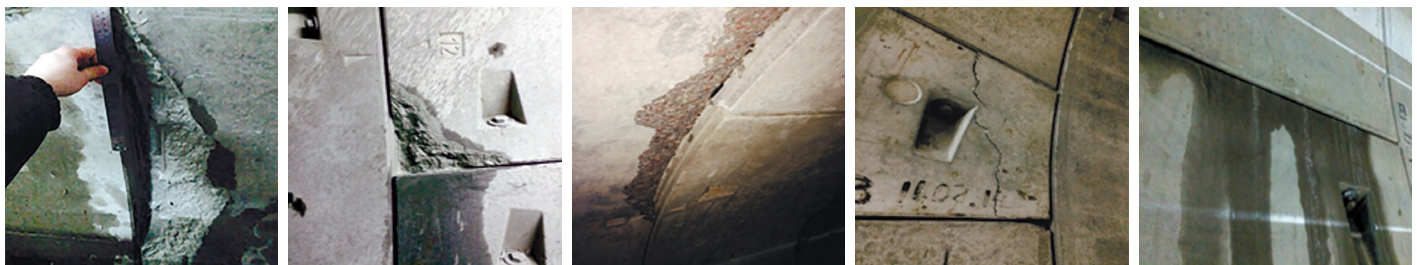
Рисунок 4.9. Сколы, трещины и течи в сборной водонепроницаемой обделке из высокоточных железобетонных блоков
