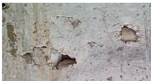
Полости от зависания бетонной смеси
