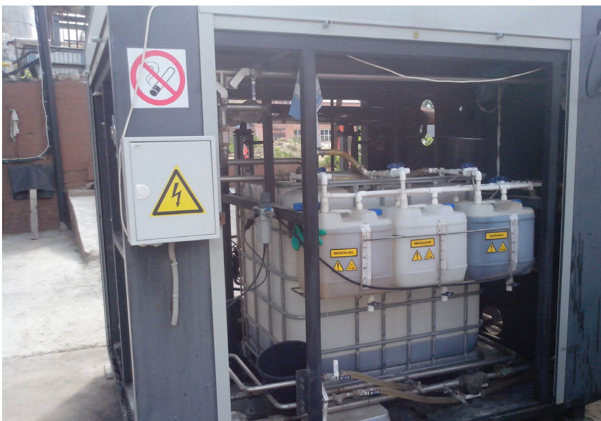
Эмульсионная установка Рязаньавтодор
