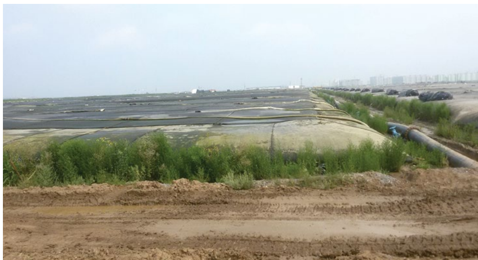
Ликвидация накопителя сточных вод в г. Астане (Республика Казахстан). Дренажная площадка для обезвоживания сероводородных илов в геотекстильных тубах объёмом 1 650 м 3
