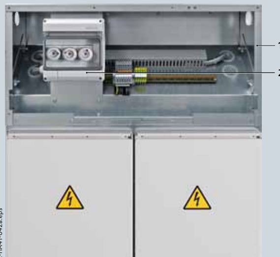
Низковольтная ниша измерительной ячейки, тип М, крышка открыта.
