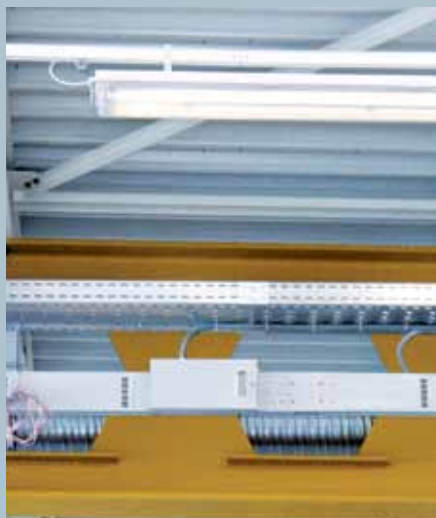
Новая осветительная установка на участке формовки изделий
