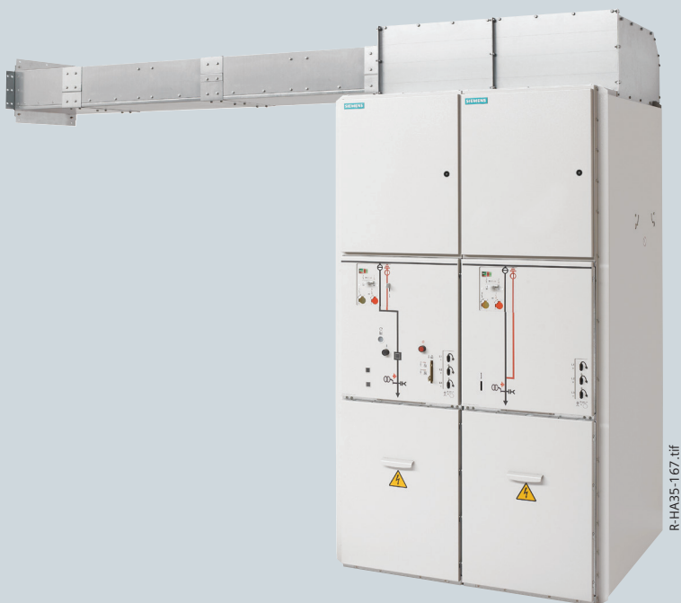
Пример: 3 панели NXPLUS C с каналом сброса давления и устройством вывода, направленным влево
