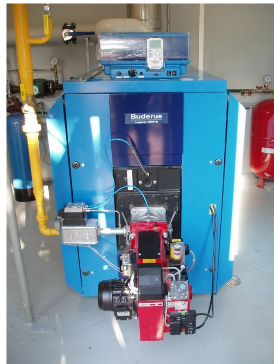
Частная котельная, Таллинн, Эстония
