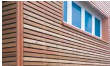
Фасады с открытыми швами в облицовке.
