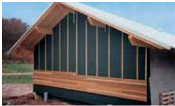
Фасады с открытыми швами в облицовке.
